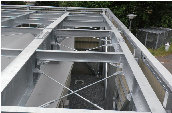
写真3 ガバナーステーション外観（補強工事後屋根面） Photo 3 Governor station after reinforce work (Roof)
